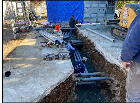
Underground Conduit Runs
