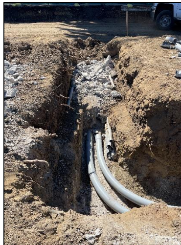
Site Electrical P.O.C.
