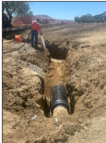
Site Storm Drain P.O.C.
